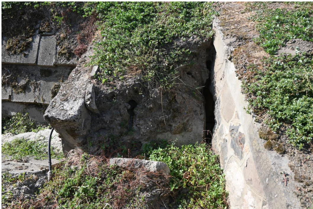
7. sz. kép: Elmozdult áteresz csőelemek, tönkrement támfalelem.
