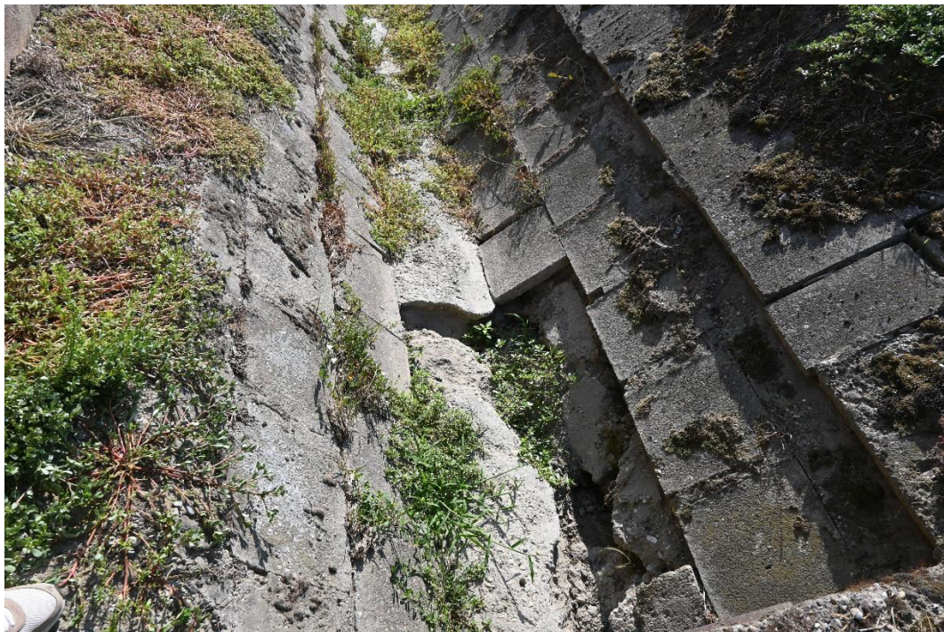
9. sz. kép: Kimosódás az áteresz kifolyási oldalán, tönkrement árokburkolat.
