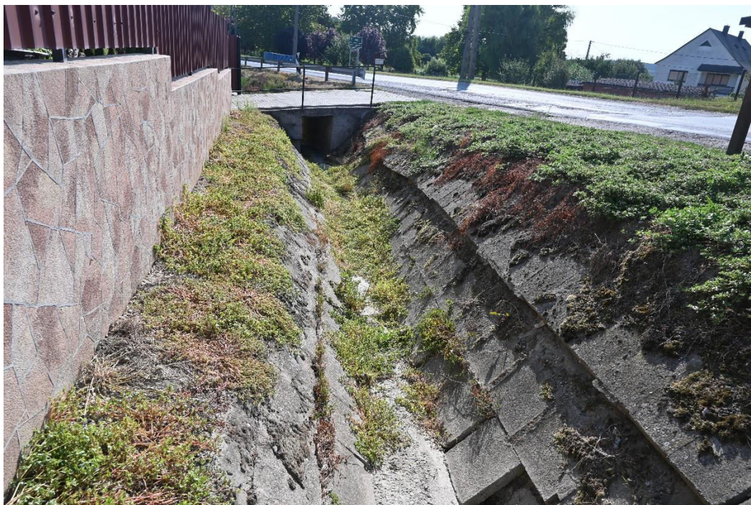
10. sz. kép: A 8216. j. út oldali megroskadt, elcsúszott rézsűburkolat.
