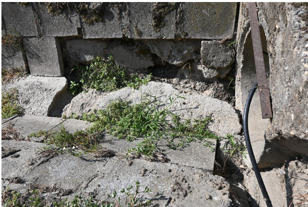
8. sz. kép: Kimosódott mederelemek, megroskadt rézsűburkolat.
