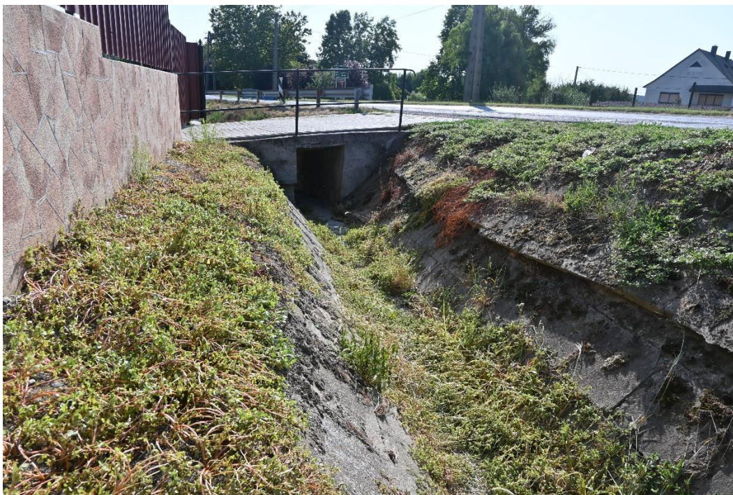
11. sz. kép: A 8216. j. út oldali megroskadt, elcsúszott rézsűburkolat.
