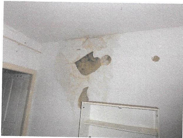
A konyhánál erős leázás tapasztalható, amely a tetőfedés hibájából származik.
