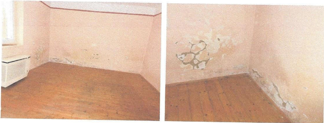
A nappali hajópadlós és gázkonvektor fűtésű helyiség, ahol a falak erősen vizesek.
